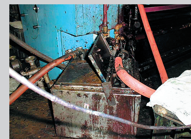
Sovraccarico di una vasca intermedia caratterizzato da scarsa manutenzione. Foto Technotrans.
